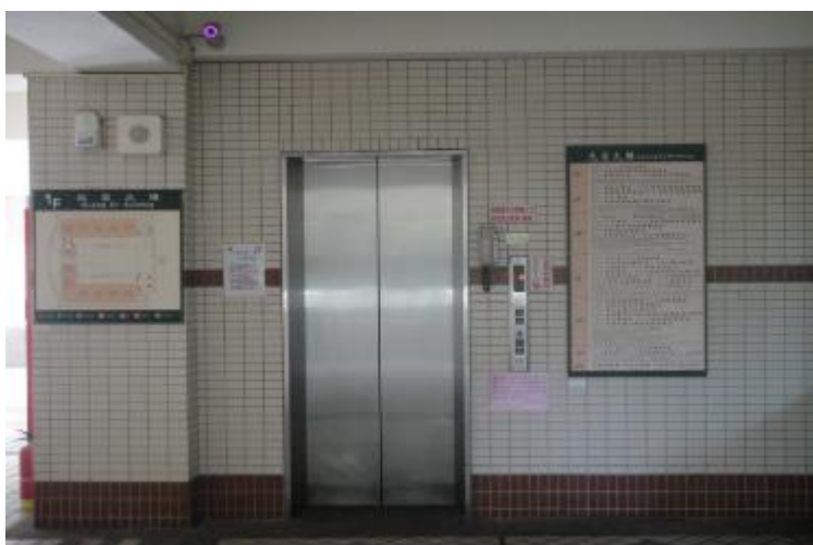
元培科技大學光恩樓電梯
