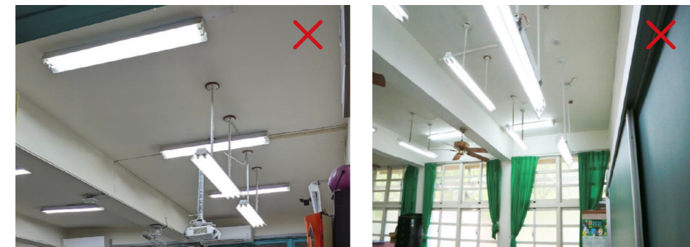
圖 17 國小教室安裝工事燈，造成教室眩光過高
