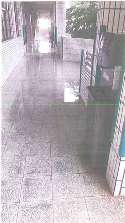
建物排水不及，形成積水
