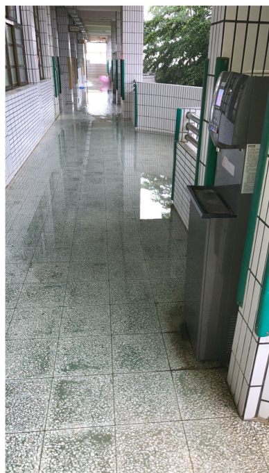
建物排水不及，形成積水
