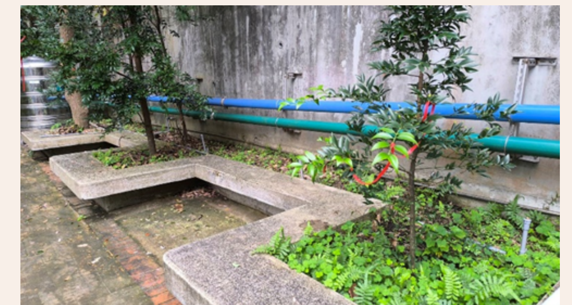
中部小田園社於科學樓擋土牆下方花園高設置澆灌設施
