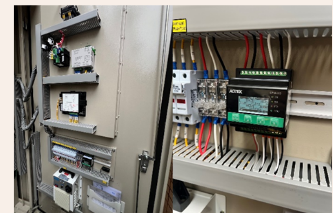
資本門編列一組智慧電錶，裝設於忠孝樓與仁愛樓電盤上。
