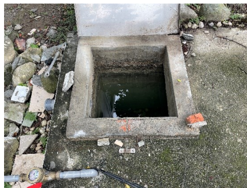
新增第一棟大樓雨水回收系統作為沖廁使用
