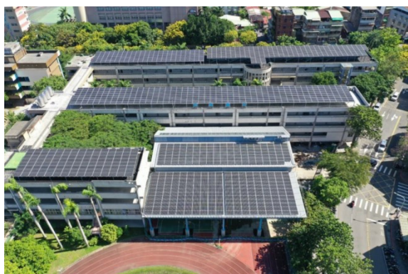
再生能源：全校區太陽能光電板設置
