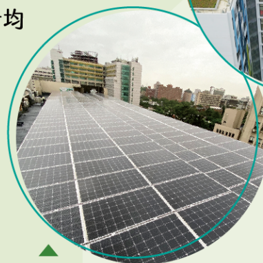
▲ 第四教學大樓屋頂太陽能板
