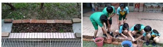
109年6月9日天溝破裂，雨水直接 灌注地面，進行土壤保育教學
