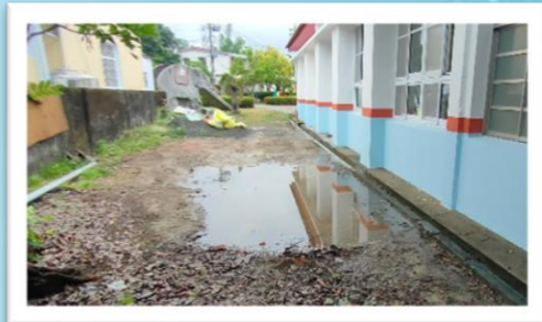
遇強降雨，排水不良易產生積水
