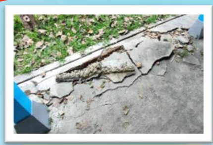
鼠根嚴重導致地板破裂
