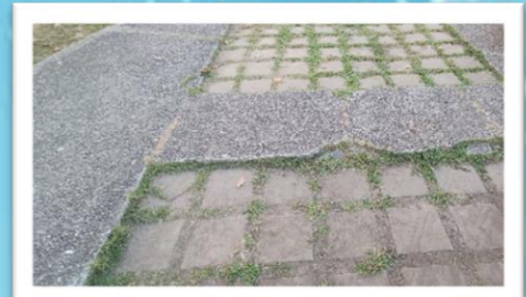
北側廣場地坪坍塌下陷
