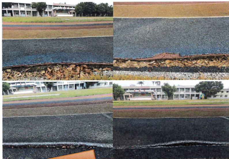
PU 跑道鋪面隆起、龜裂損壞情形嚴重
