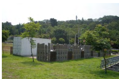
圖四 MBR 汙水處理場
