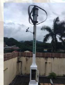
智慧風力發電裝置
