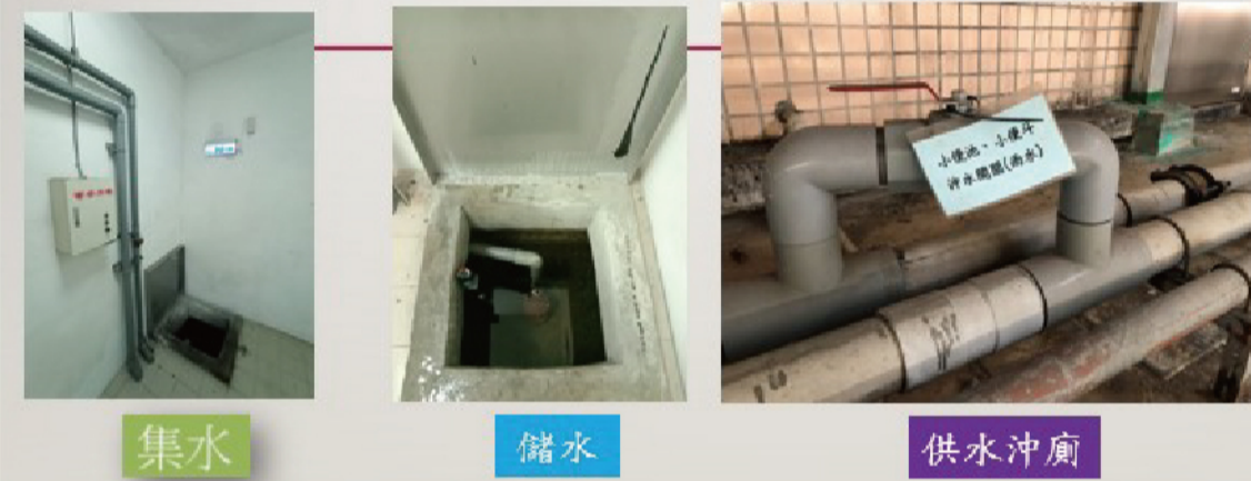
(僅行政大樓使用筏基雨水沖廁，大部分雨水回收未妥善再利用)
