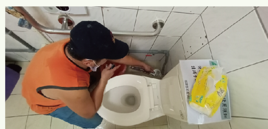
(巡檢查出馬桶及室內柱漏水)
