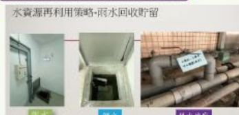
(僅行政大樓使用積蓄雨水沖廁，大部分雨水回收未妥善再利用)
