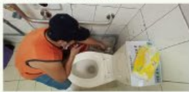
(巡檢查出馬桶及室內管線漏水)
