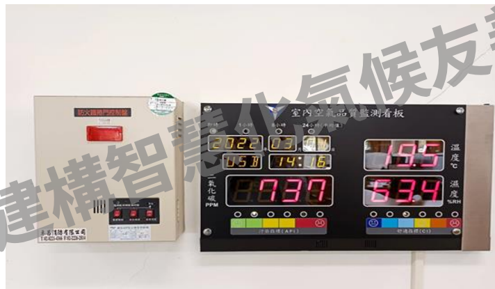
本校室內空氣品質監測設備
