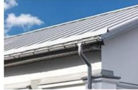
(屋頂雨水)屋頂雨水收集系統
