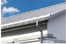
(屋頂雨水)屋頂雨水收集系統
