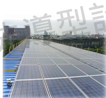
校舍屋頂太陽能板
